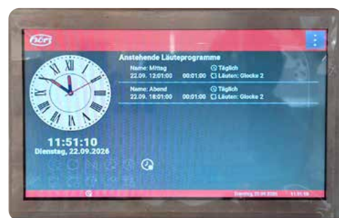
Bedienfeld der neuen Anlage
